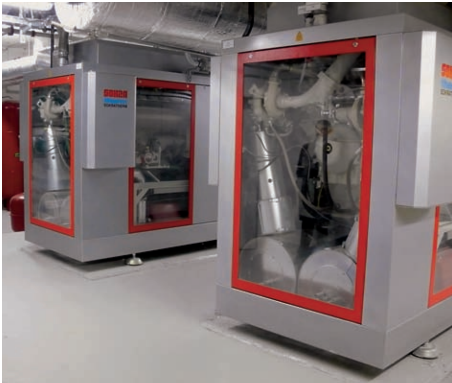
Herzstück des Energiekonzepts im Forum Duisburg: Die BHKW-Module erzeugen Strom und Wärme, die über eine Absorptionskältemaschine für die Kühlung genutzt wird.
