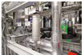
Bild: Geiger Energietechnik
